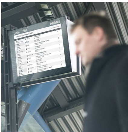
Haltestellenmonitor am Bahnsteig
